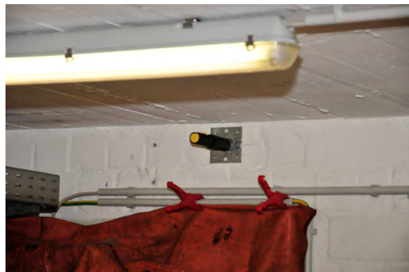
Bild 2.5: Montierte Sensoraufnahme – Sensor2
