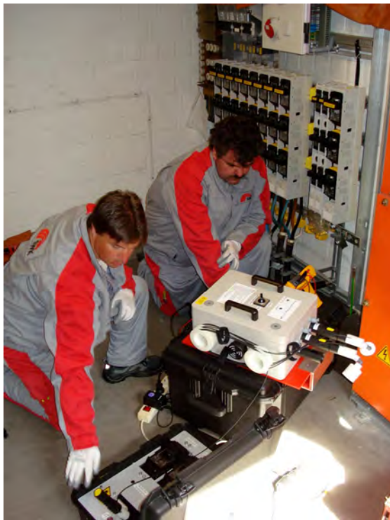
Bild 2.6: Funktionsprüfung Steuergerät DEHNarc STG
