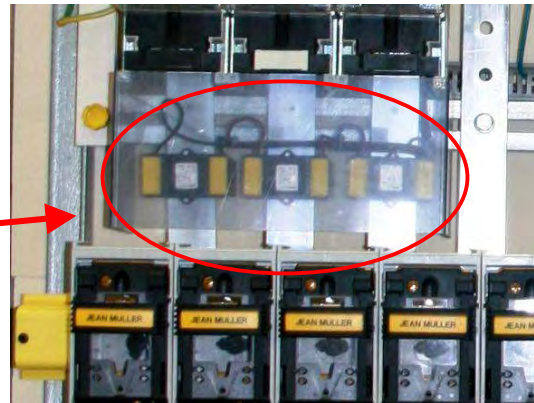
Bild 2.3: Sammelschienen- verbindung mit Abdeckung
